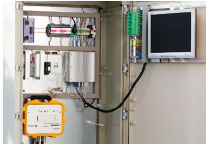
Ortsfeste Geomonitoring- Anlage
